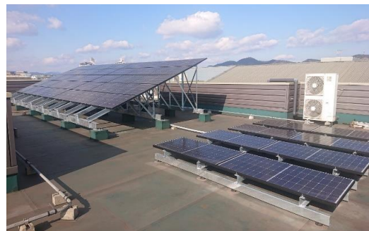
本社太陽光発電、蓄電池
