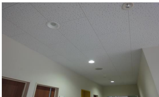
廊下・トイレ自動点滅
