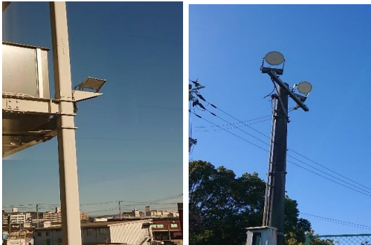
本社・従業員用駐車場夜間照明のLED化
